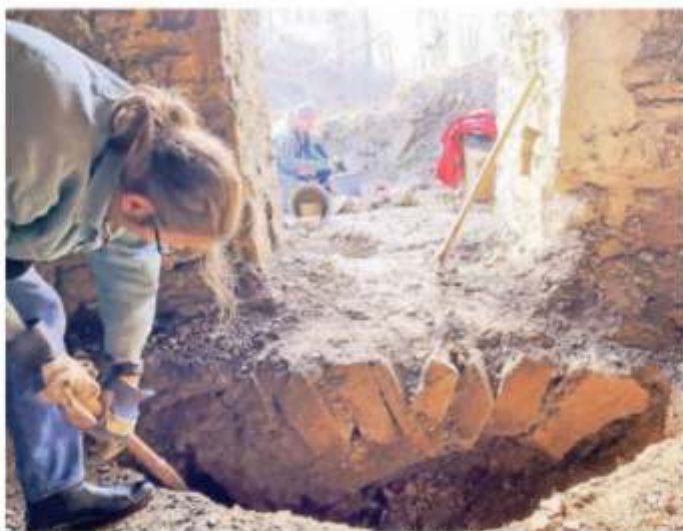
Bei den Arbeiten legte der Förderverein Denkmalschutz und Denkmalpflege ein Gewölbe frei.
